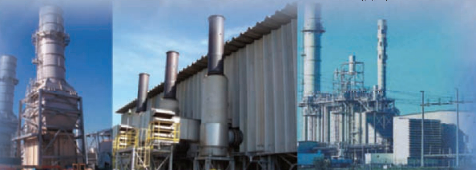
Dieses 100-MW-Turbinensystem beinhaltet von Universal Silencer gelieferte Filtrations- und Schalldämpfungskomponenten.
